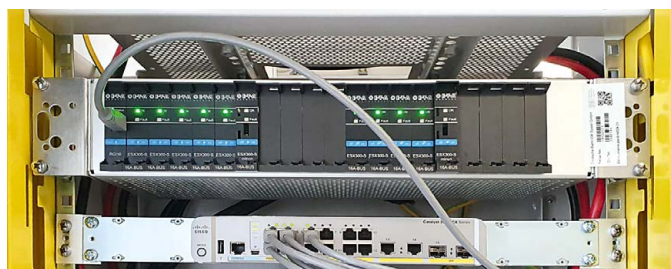
ControlPlex® Rack: sichert, steuert und überwacht kommunikationstechnische Anlagen der Deutschen Bahn
